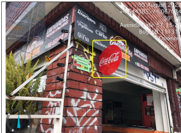
Fotografía No. 3. Fachada del establecimiento (por Calle 57), se evidencia UN (1) aviso saliente, volado y adicional al único permitido en la fachada del inmueble.
